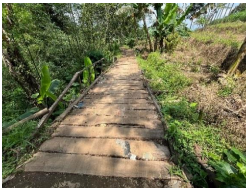
Gambar 1. Kondisi Jalan Sumber: Dokumentasi Pribadi, 2024
