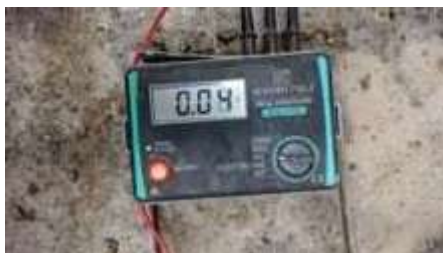
Gambar 9. Hasil pengukuran pentanahan area masjid
