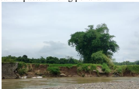
Gambar 1. Kerusakan Dinding Penahan Tanah Sumber: Dam Genduk Panti
