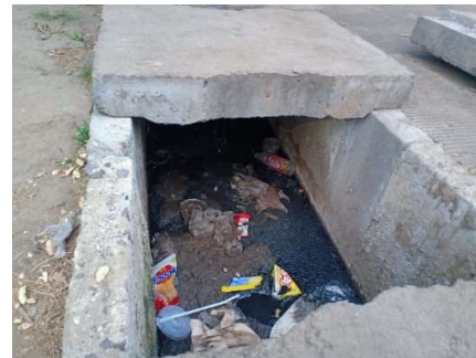
Gambar 7 Kondisi Saluran TPI Sumber : Observasi di Lapangan
