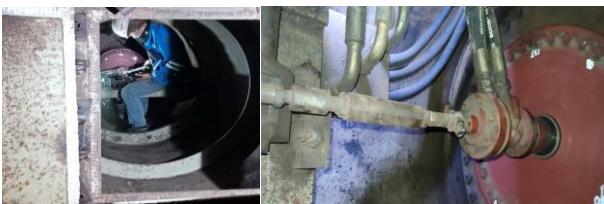
Gambar 15. Kondisi servo & linkage primary air fan
