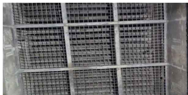
Gambar 13. Kondisi strainer inlet PAF
