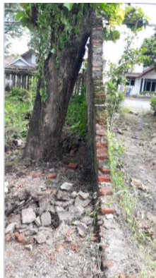
Gambar 1. Pagar Tembok samping lahan Pembangunan RS UM Jember Miring
