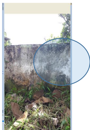
Gambar 2. Terjadi retak pada dinding pagar Lahan Pembangunan RS UM Jember
