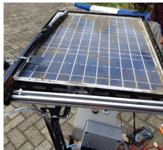
Gambar 5. Panel surya kondisi dengan debu
