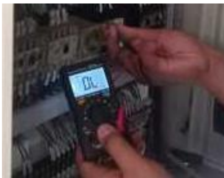
Gambar 8. Kondisi kontaktor rusak
