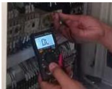
Gambar 8. Kondisi kontaktor rusak
