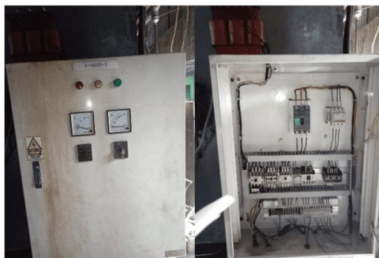
Gambar 3. Tampak luar dan dalam panel kontrol listrik mesin press chin fong CCP 100
