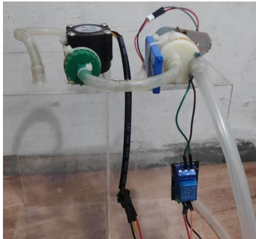
Gambar 14. Penempatan relay module , pompa air, dan water flow sensor (samping)
